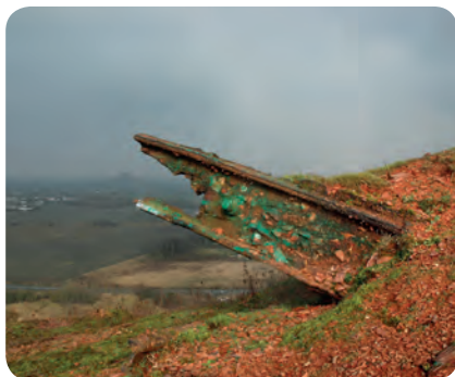
Terril Renard : vestige d'un rail de la rampe de chargement. Mission Bassin Minier
