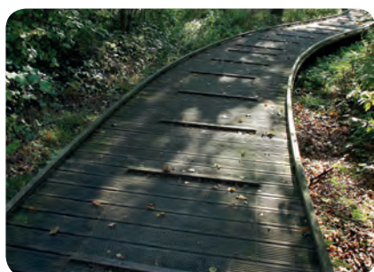
Platelage bois en zone humide, un grillage posé sur le platelage assure la fonction anti-dérapante, S. Dhote
