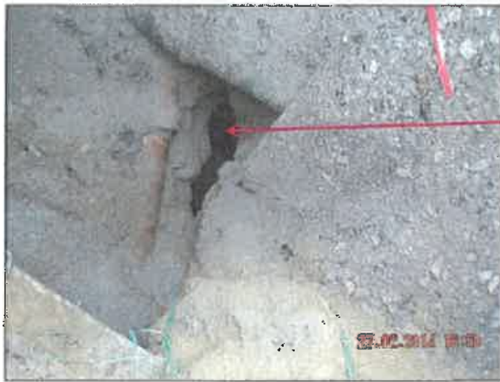
Figure 10 : Rétrécissement de la cavité au niveau d'un croisement de plusieurs canalisations
