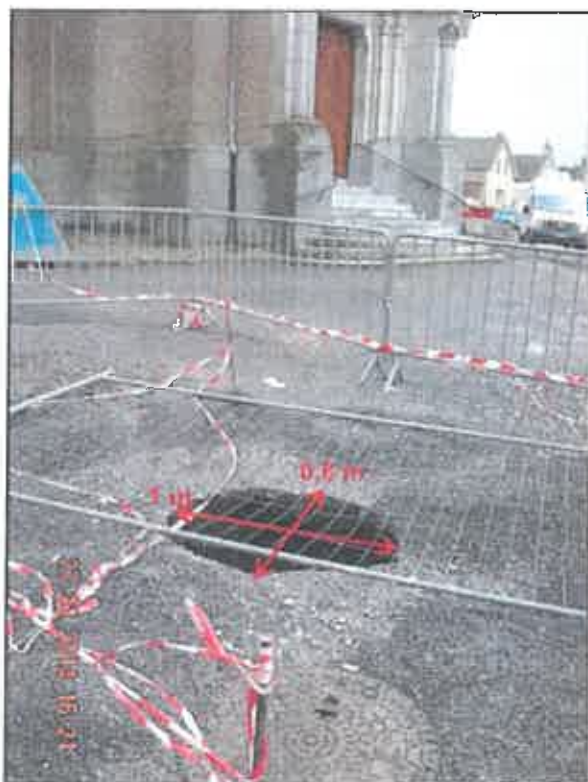
Figure 6 : Vue générale de l'effondrement de terrain place Gambetta
