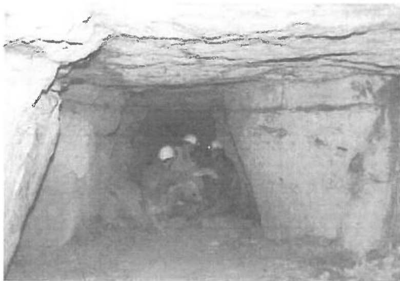
Dans la carrière de la Place, à Walincourt, les piliers sont généralement bien découpés et bien alignés. L'ouvrage est pourtant fragile. Un effondrement a déjà détruit une maison, en 1984, et des travaux de consolidation s'avèrent nécessaires sous la route.
