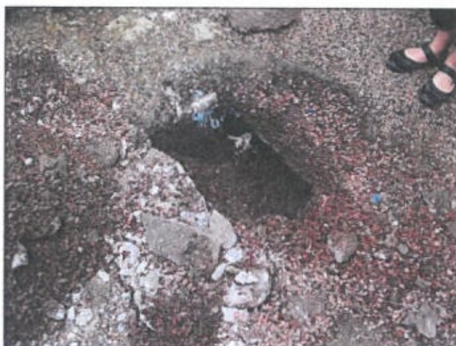
Illustration 5 : vue de l'affaissement avant le déblaiement des remblais.
