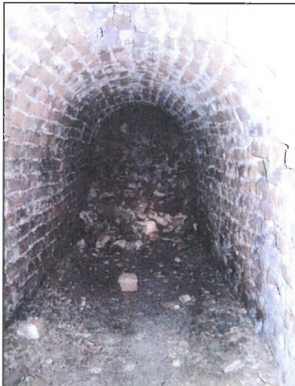
Figure 6 : Galerie - secteur effondré
