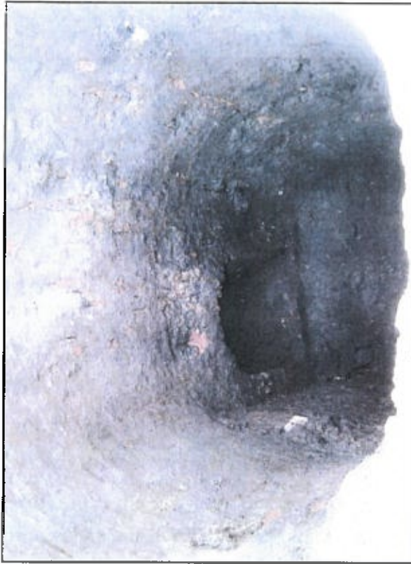
Figure 4 : Entrée de galerie avant traitement (extrait DOE)
